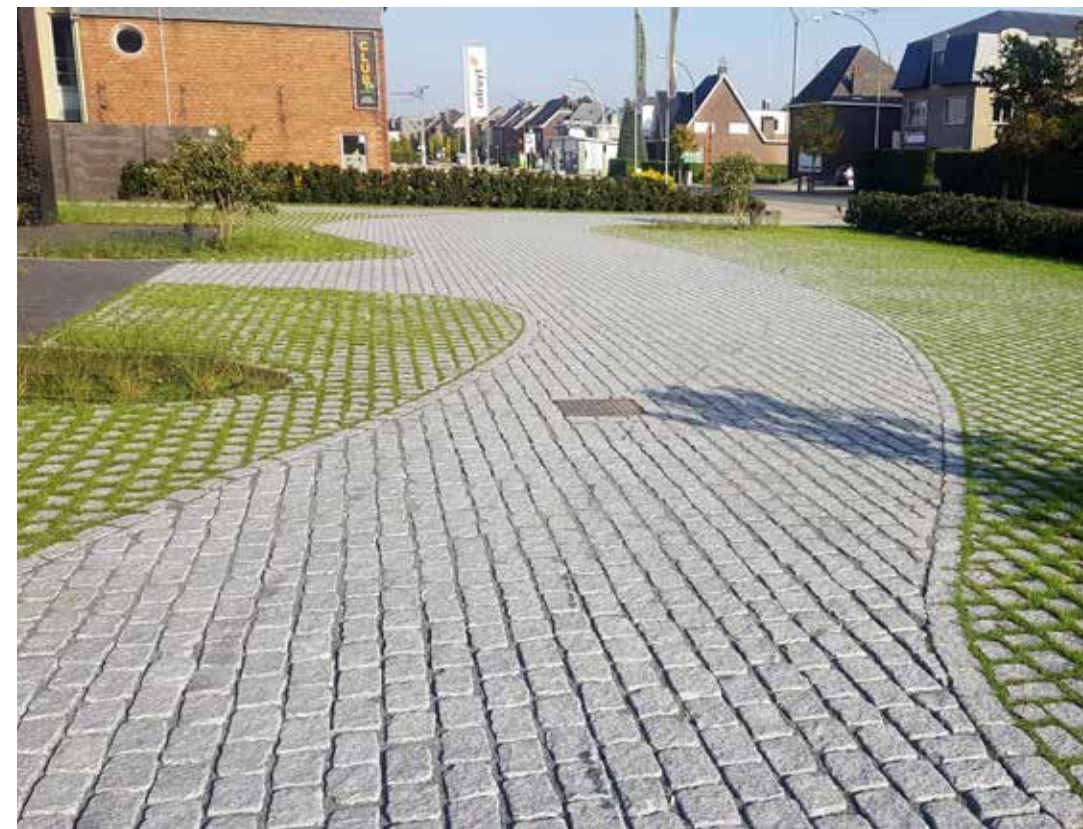
Het fijnkorrelige graniet kan geplaatst worden met een bredere voeg gevuld met split zodat de verharding perfect waterdoorlaatbaar is.
